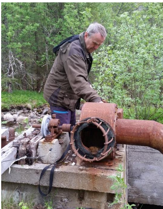
Helge inspiserer turbinen under ryddinga i den sammenfalte kraftstasjonen.
